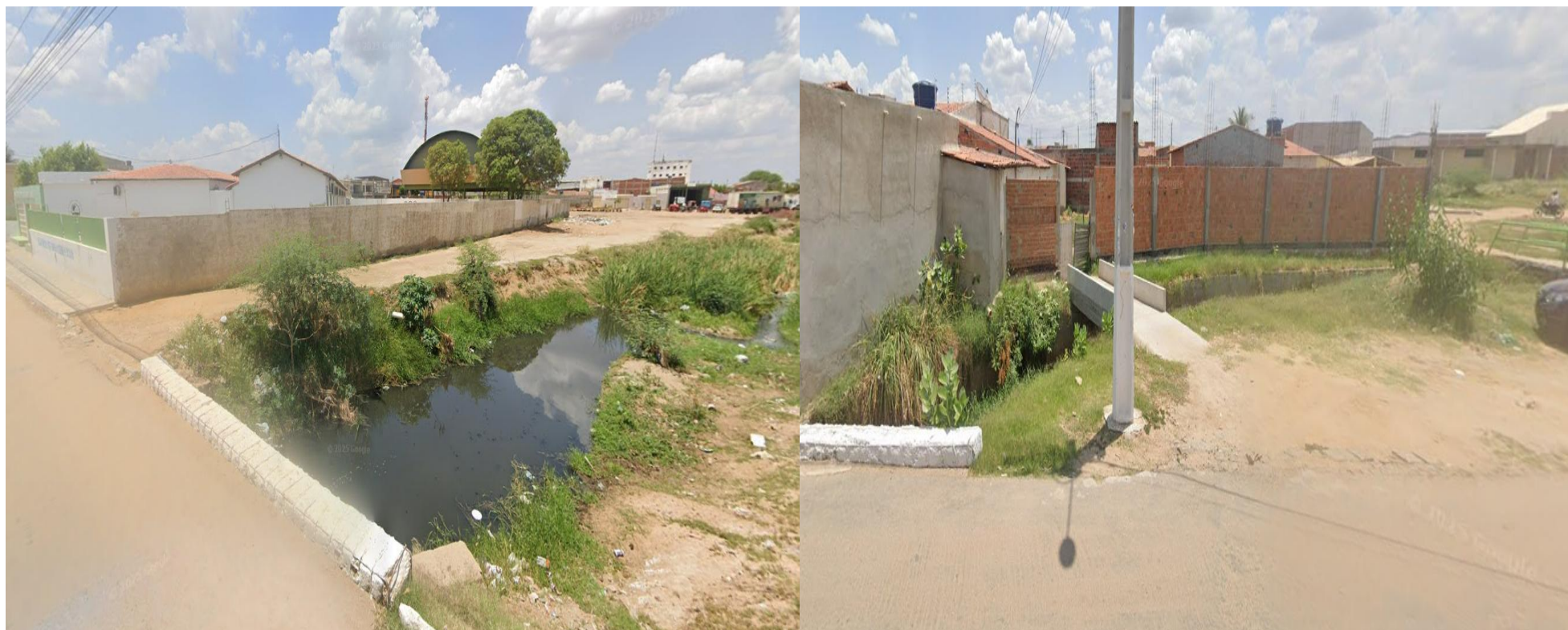
Figura 7. Zona de Risco (Rua Petrolinio dos Santos – Itaberaba)
