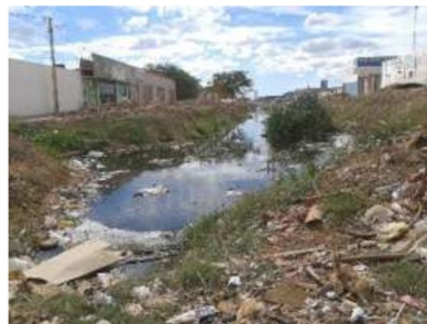
Figura 49 – Canal de drenagem com
