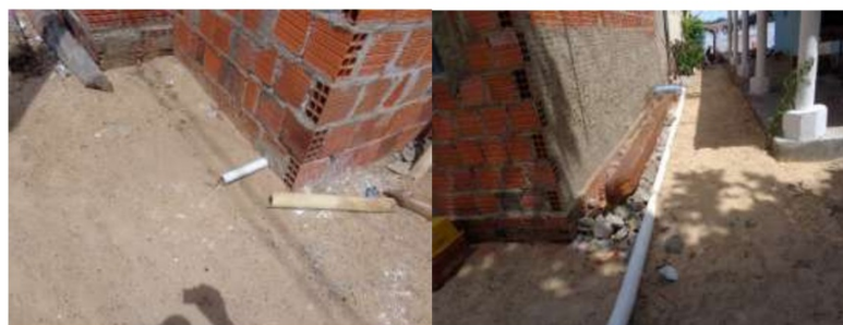
Figura 21 - Lançamento de esgoto a céu aberto
