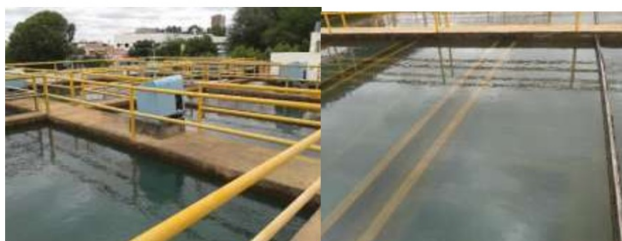
Figura 31 – Floculador (esquerda) e decantador (direita)
