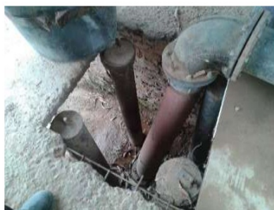
Figura 29 – Poço na área da estação de captação de água bruta
