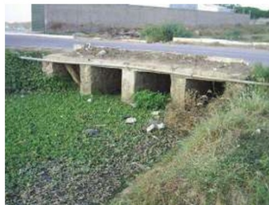
Figura 53 – Travessia obstruída do Riacho Macarrão
