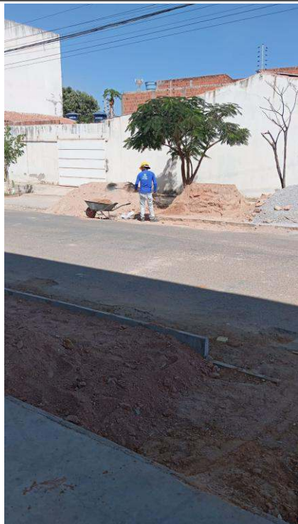
- Assentamento de meio fio. - Colocação de entulho na calçada. - Descarregamento de material.
