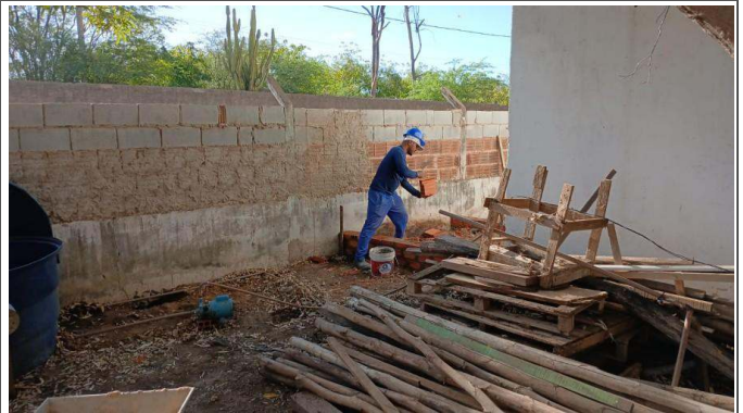
- Fabricação de base pra caixa d'água do chão.- Limpeza da área. - Colocação de aterro na base da caixa.
