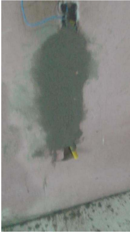
- Acabamentos das caixinhas de energia
