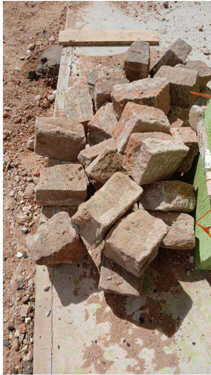
- Retirada de paralelo
