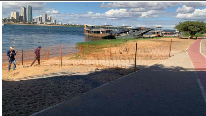
- Isolamento da área de execução da rampa;- Execução de perfuração para instalação do corrimão;- Limpeza do local;
