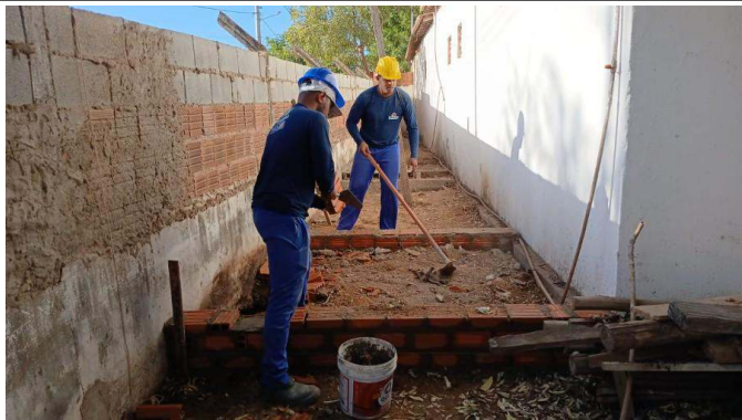
- Fabricação de base pra caixa d'água do chão.- Limpeza da área. - Colocação de aterro na base da caixa.
