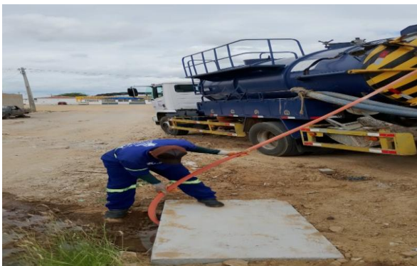
RES. DR HUMBERTO - SERVIÇO DE SEWERJET
