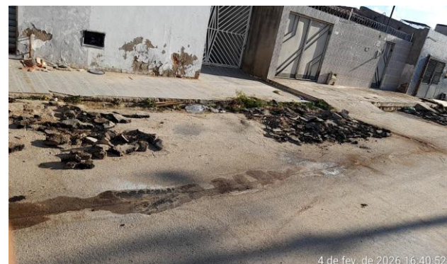
RUA SÃO JOÃO - MAN. PAVIMENTO ASFÁLTICO
