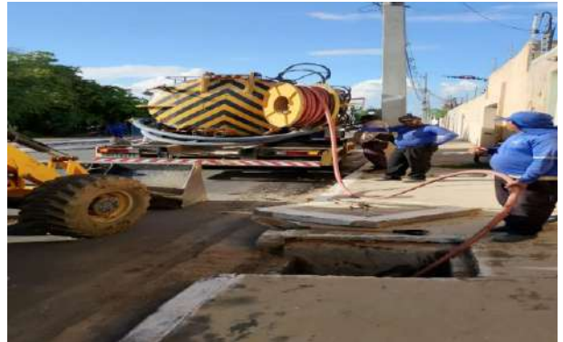
R MANOEL SEVERO - SEWERJET
