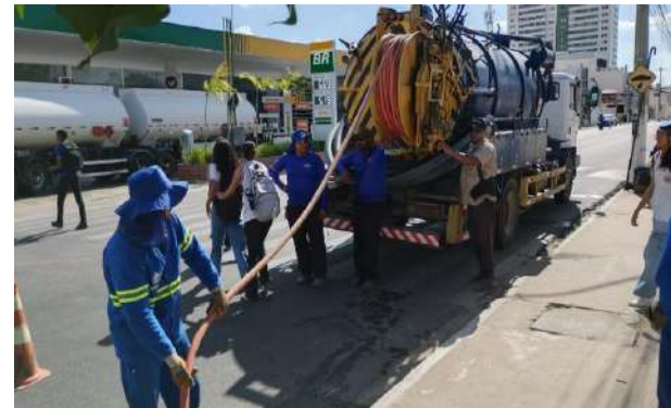
AV ANTONIO CARLOS - SEWERJET
