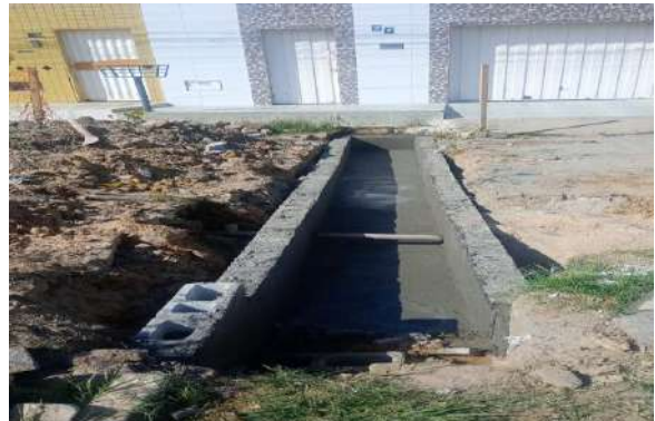
DEAN - CAIXA DE PASSAGEM
