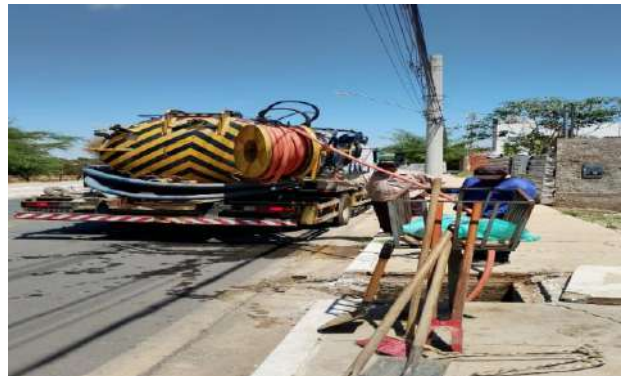
R MANOEL SEVERO - SEWERJET
