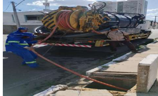
AV ANTONIO CARLOS - SEWERJET
