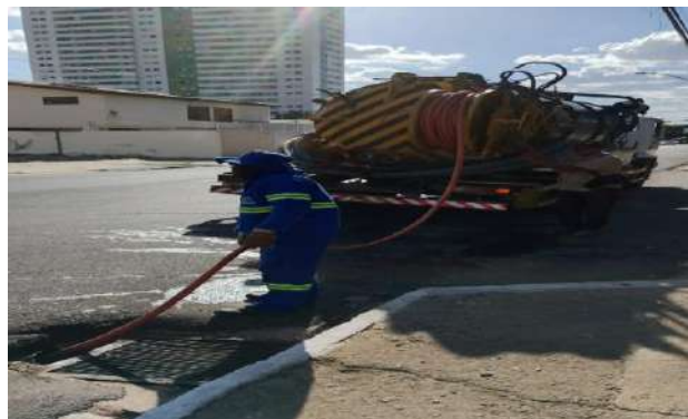
AV ANTONIO CARLOS - SEWERJET
