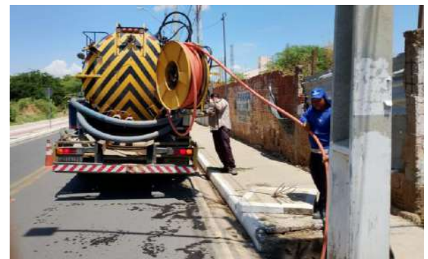
R MANOEL SEVERO - SEWERJET
