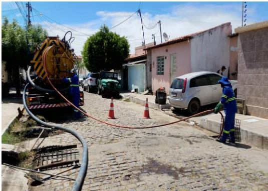
R DA SÍRIA - SEWERJET
