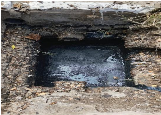
R DA SÍRIA - SEWERJET
