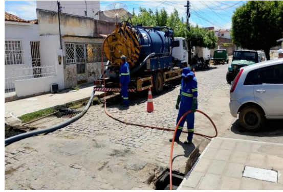
R DA SÍRIA - SEWERJET
