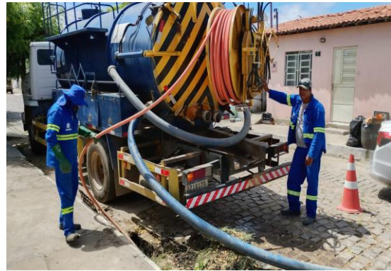
R DA SÍRIA - SEWERJET
