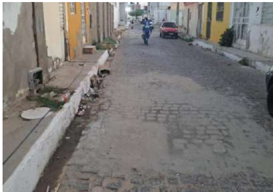
TRAVESSA MATATU - TAPA BURACO PARALELO
