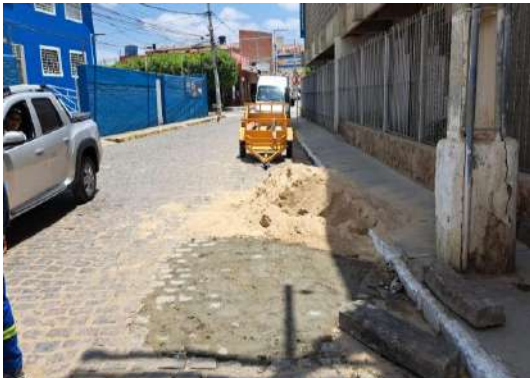
TRAVESSA MATATU - TAPA BURACO PARALELO
