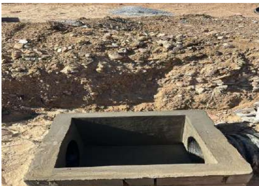
BA210 - CAIXA DE PASSAGEM
