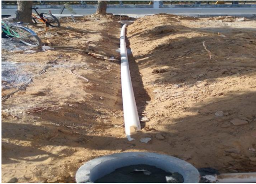
PRAÇA ALFREDO ALVES - REDE DE DRENAGEM
