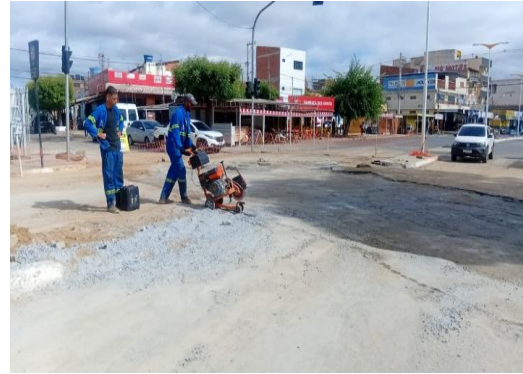
AV ADOLFO VIANA - CORTE DE ASFALTO
