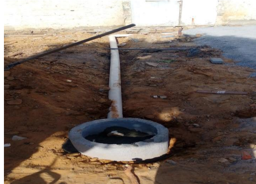
PRAÇA ALFREDO ALVES - REDE DE DRENAGEM
