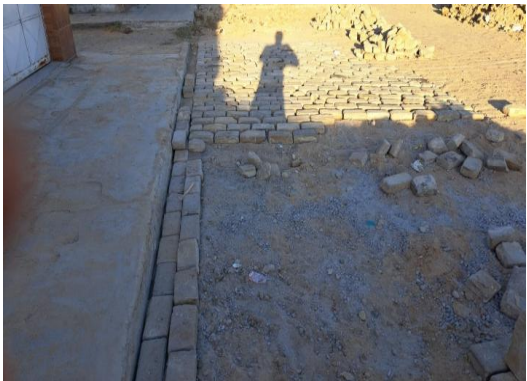
RUA A DOM JOSÉ - TAPA BURACO PARALELO
