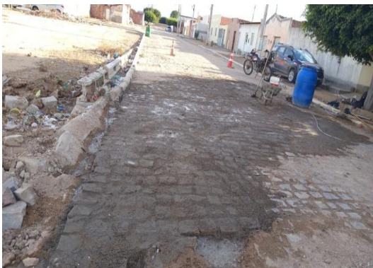
RUA A DOM JOSÉ - TAPA BURACO PARALELO
