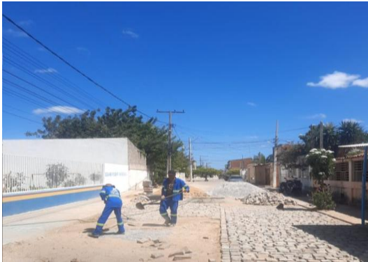
RUA A DOM JOSÉ - TAPA BURACO PARALELO
