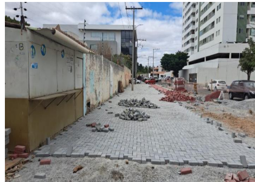
PRAÇA ALFREDO ALVES - REDE DE DRENAGEM
