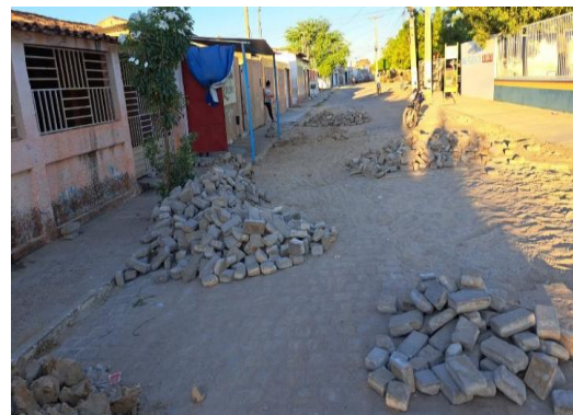
RUA A DOM JOSÉ - TAPA BURACO PARALELO
