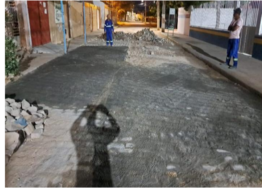
RUA A DOM JOSÉ - TAPA BURACO PARALELO
