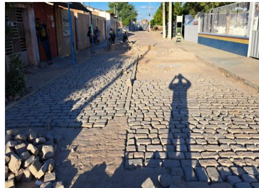
RUA A DOM JOSÉ - TAPA BURACO PARALELO
